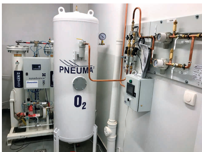
Wytwornica tlenu z systemem automatycznego przełączania na butle awaryjne znajdujące się na zewnątrz budynku
