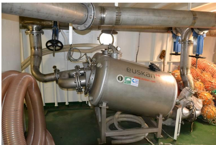
Fot. 14. Instalacja firmy Euskan na kutrze rybackim (fot. MIR-PIB)
